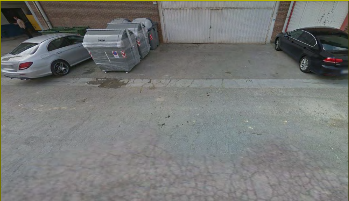
Uraren bide-zorua eta gainazaleko kanalizazioa hondatzea
